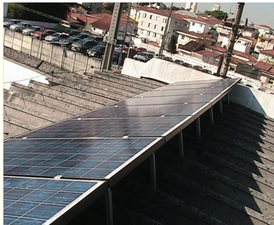
Figura 1 - Módulos Fotovoltaicos instalados em Congonhas
