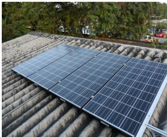
Figura 2 - Módulos Fotovoltaicos instalados em Jacarepagua
