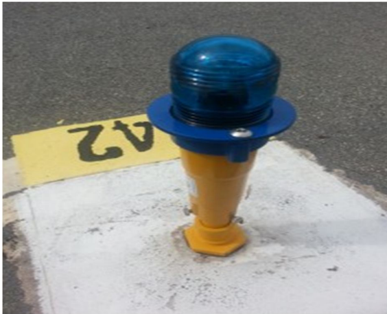
Figura 5 - Luminária LED para taxiway
